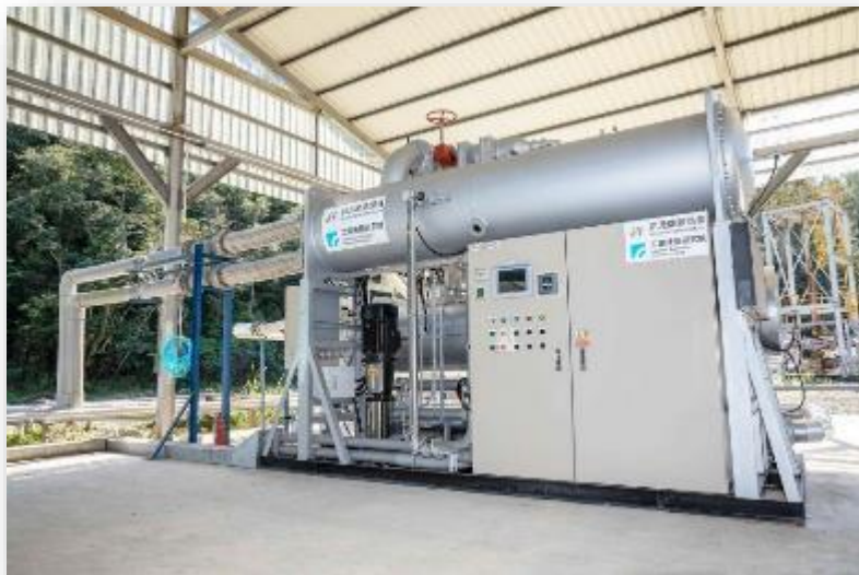
清水地熱300kW 渦輪式ORC發電機組
